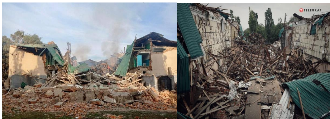
Рис.3 Зруйнований районний будинок культури після прямого влучання ракети
